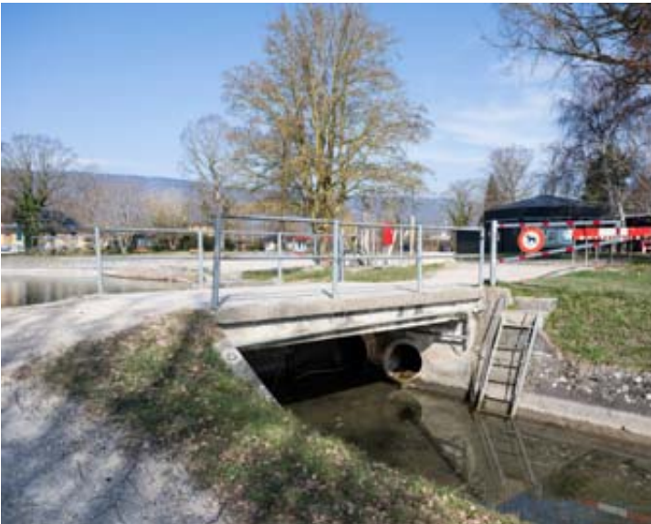
Le pont qui mène à la partie insulaire du camping devra être renforcé de manière à pouvoir supporter le poids des camions.
