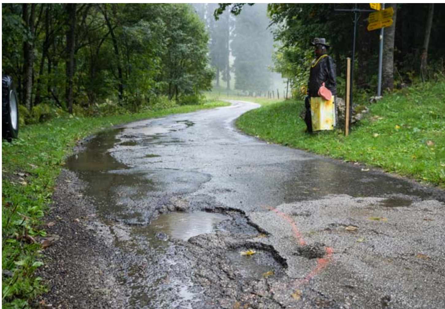
La route menant au Grand-Sommartel est fortement endommagée. LUCAS VUITEL
