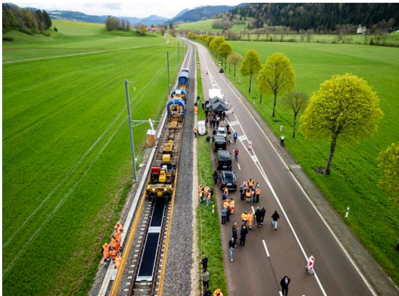
En avril 2025, la centrale solaire sur rails, de 100 mètres de long, a été installée à Buttes et inaugurée en présence des autorités communales et cantonales. ARCHIVES KEYSTONE
