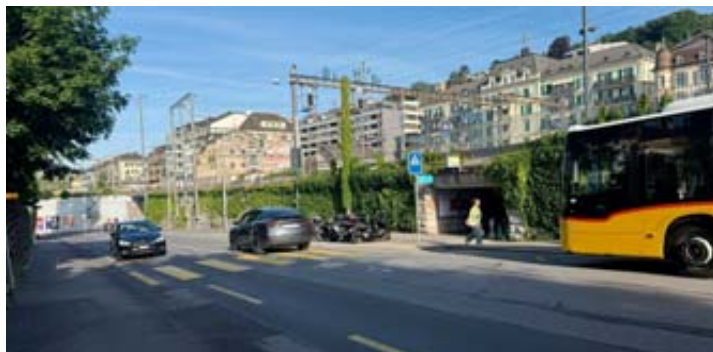
La chaussée sur le tronçon situé entre le giratoire de l'avenue de la Gare (au fond) et la gare doit être remise en état. SP-VILLE DE NEUCHÂTEL
