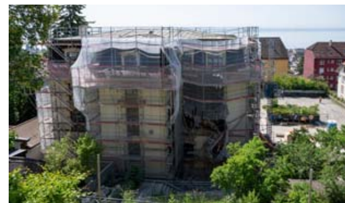
Le bâtiment s'est partiellement effondré le 23 mai du côté ouest. LUCAS VUITEL
