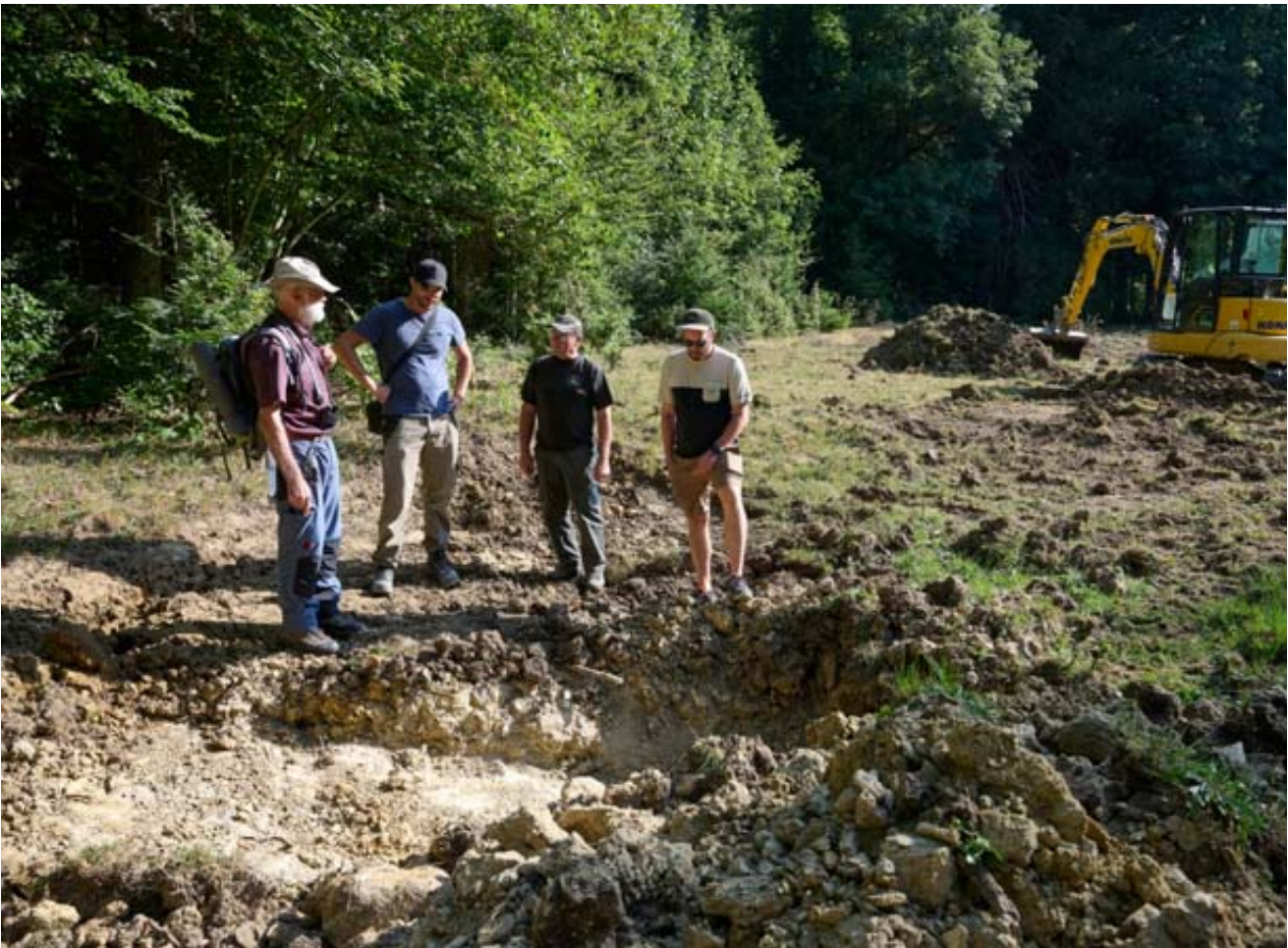
Cette ancienne marnière, située entre La Brévine et la frontière française est en cours de revitalisation. André Bühler (deuxième depuis la droite) est en train de recreuser la zone. DAVID MARCHON
